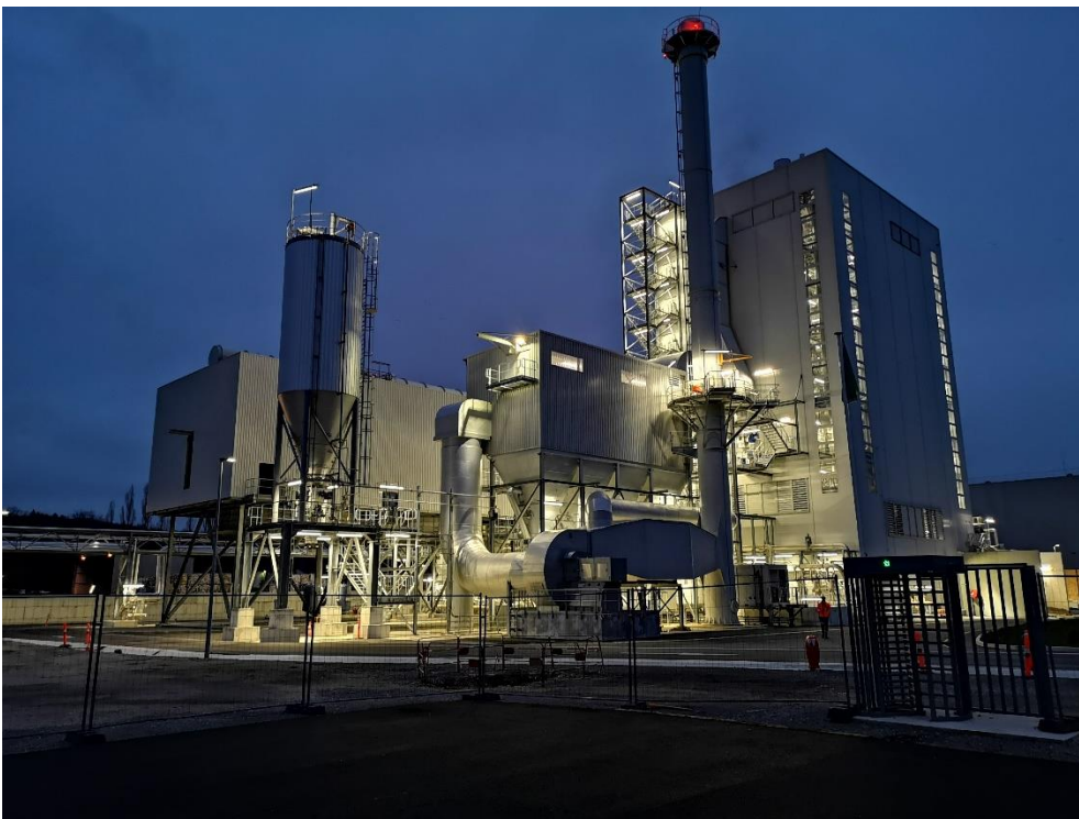
Biomasse-Kraft-Wärme-Kopplungsanlage in Novillars.
