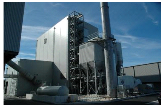
Das Biomasse Kraftwerk der Western Wood ist mit einem AET Kessel von 48 MWth und dem neuesten AET Verbrennungssystem ausgerüstet. Die strengen NOx Emissionswerte werden ohne Einsatz eines SNCR erfüllt. Stromproduktion 15 MWe.
