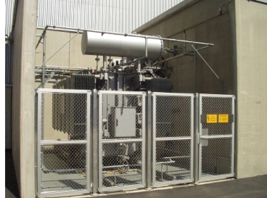
Der vom Biomasse-Kraftwerk erzeugte Strom wird transformiert, bevor er ins Netz eingespeisen wird.
