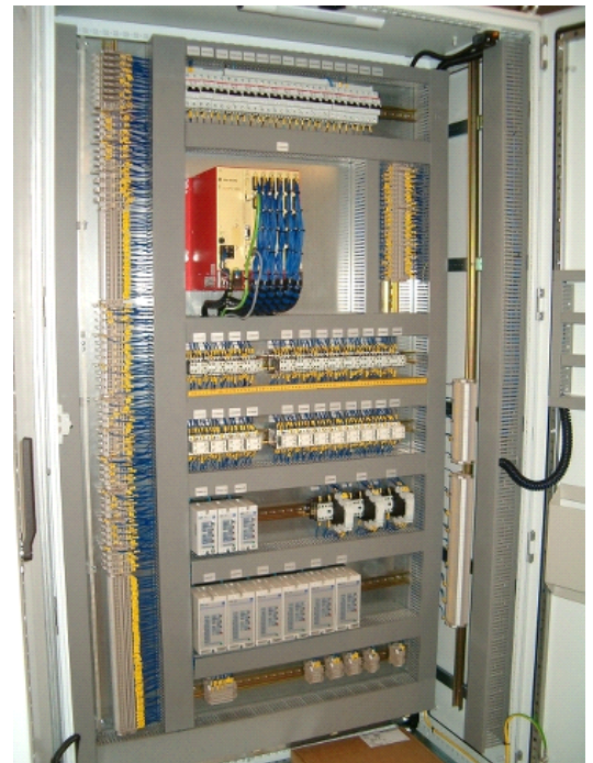
Mit fortschrittlichen und effizienten Steuerungssystemen wird ein niedriger Strom-Eigenverbrauch erreicht.
