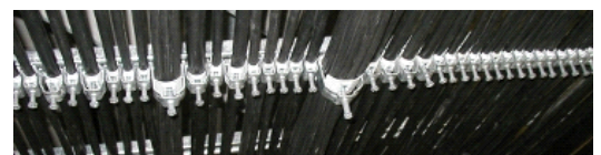
Elektrische Verkabelung für ein Biomasse-Kraftwerk
